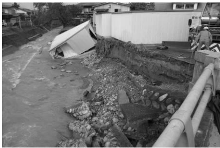
▲苔川に落ちた川べりの倉庫。この地域にも多くの世帯に床下床上浸水がひろがった。現在、このあたりの道路は、土砂が乾いて車が通るたびに砂煙をあげている。
